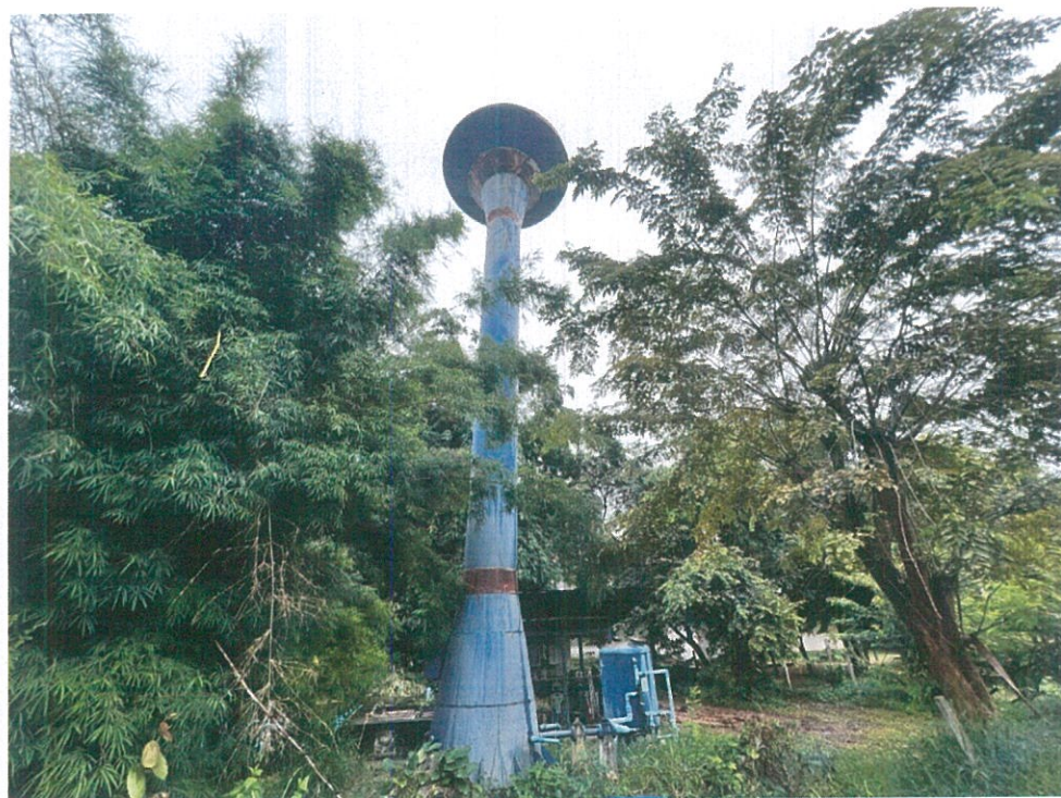
๑๐) หอถังประปา จำนวน ๑ ถัง
