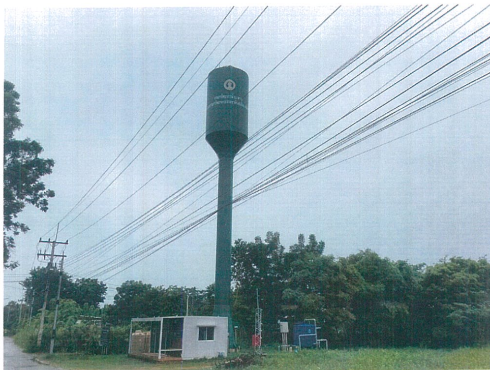
๑๒) หอถังประปา ๑ ถัง
