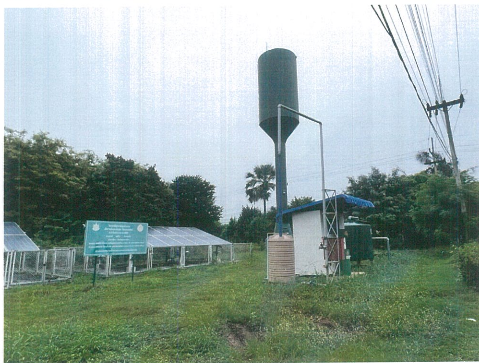
๑๑) หอถังประปา จำนวน ๑ ถัง
